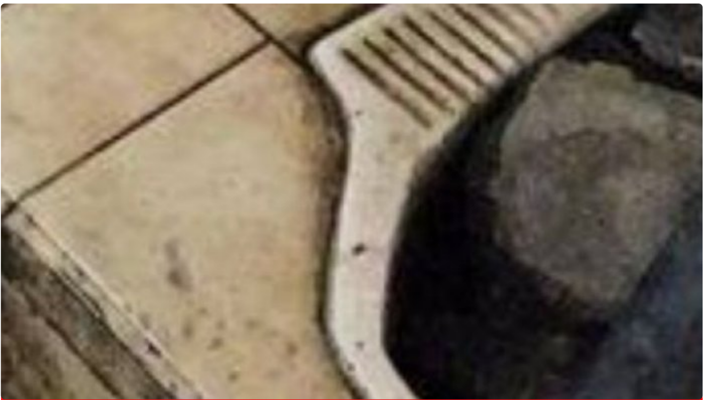
Toilet pasar rusak seperti ini, penjual dan pembeli mengeluh
